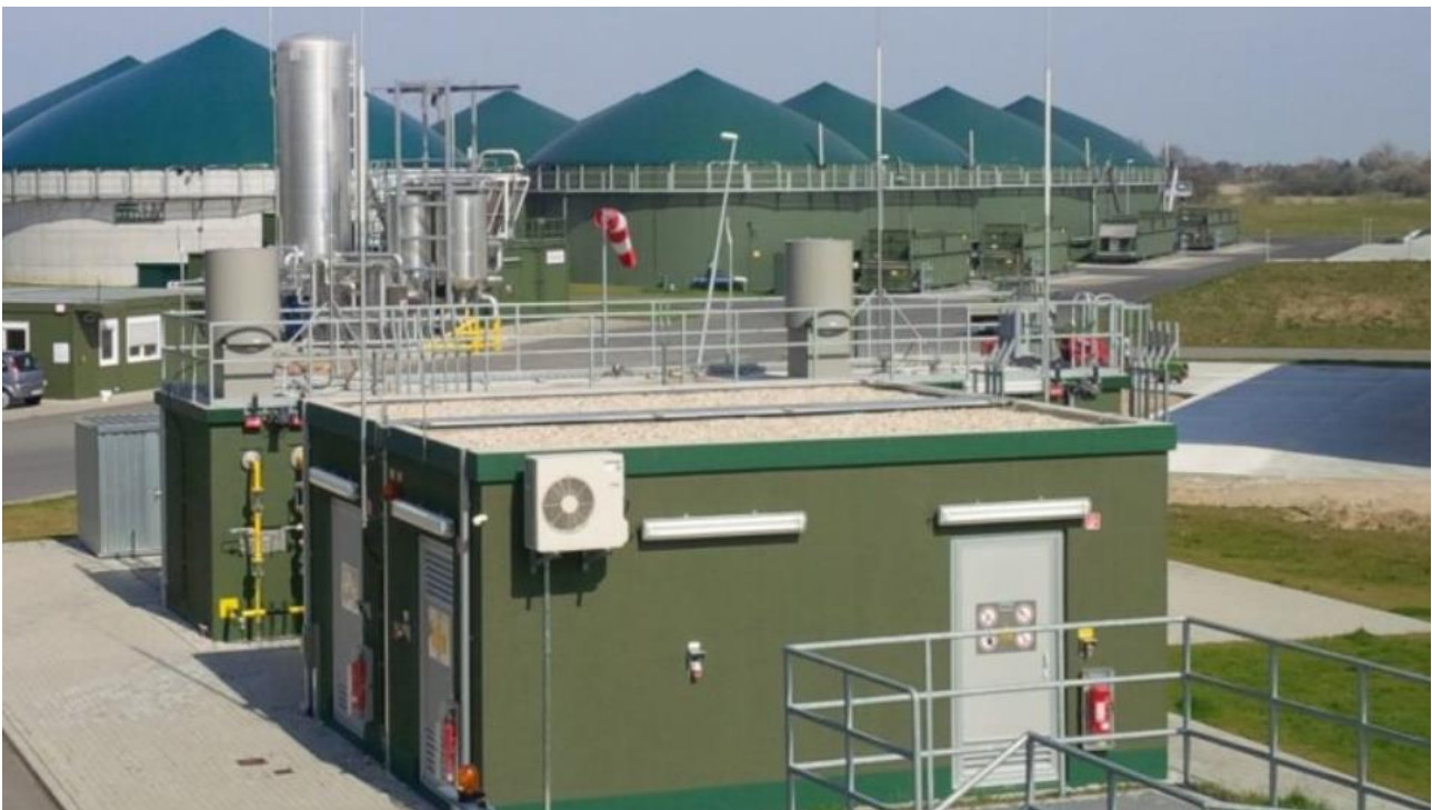
Abbildung 4: Biogasanlage, im Vordergrund LPG-Lager, LPG-Raum, Analyseraum und Kompressoren-Gebäude
