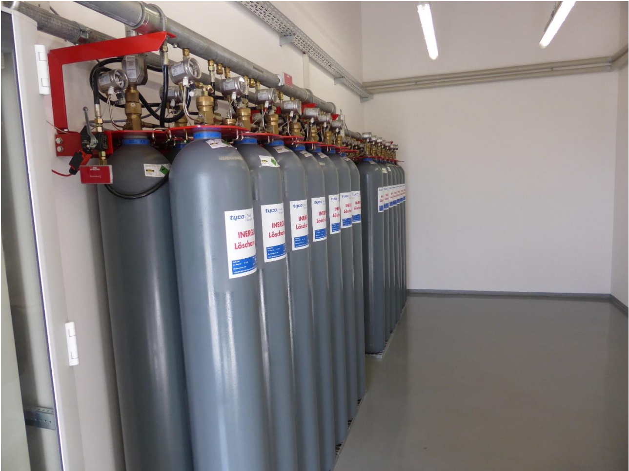
Abbildung 8: Flaschenlager der Inergen®-Löschanlage der Verdichterstation
