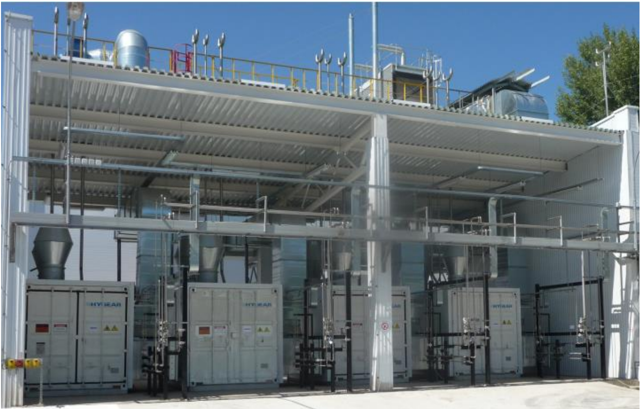
Abbildung 14: dezentrale Dampfreformierungsanlage (Bildquelle: HYGEAR) [33]
