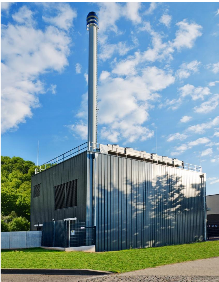
Abbildung 18: Blockheizkraftwerk (Bildquelle: © Petair - Fotolia.com)
