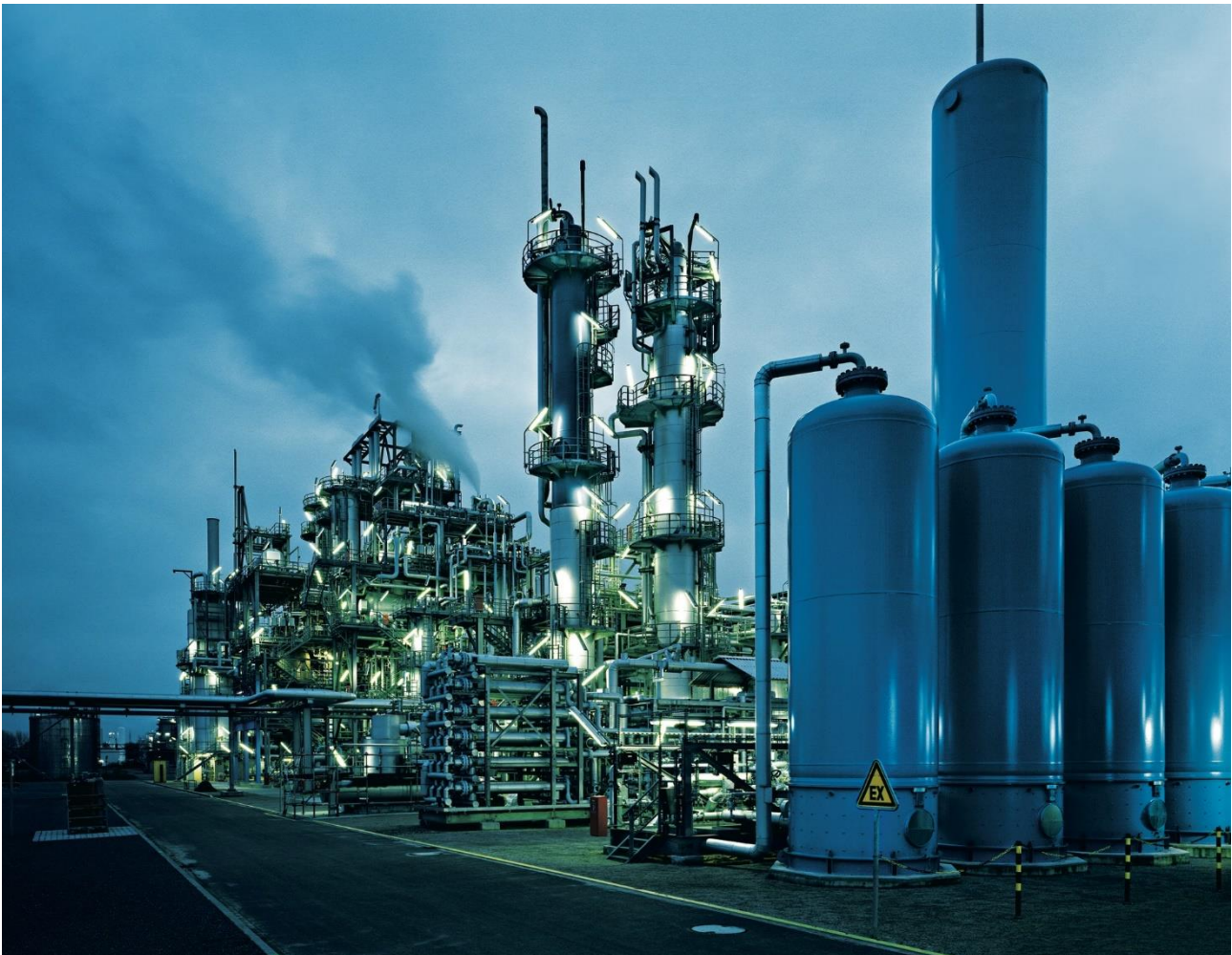
Abbildung 12: zentrale Synthesegasanlage (Bildquelle: Linde AG) [30]
