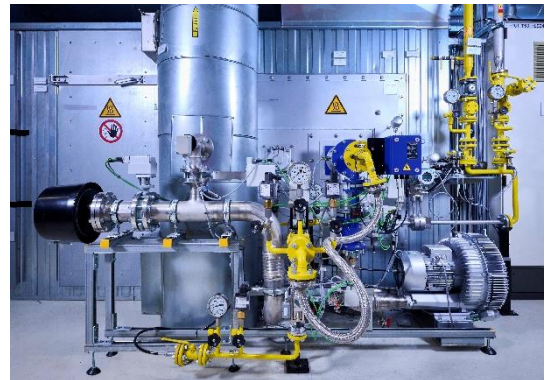
Erdgas-Wasserstoffbrenner Fa. Saacke (Quelle: BMW Group)
