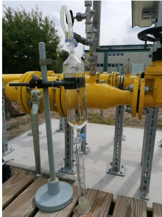
Abbildung 13: Messeinrichtung zur inneren Dichtheitsmessung
