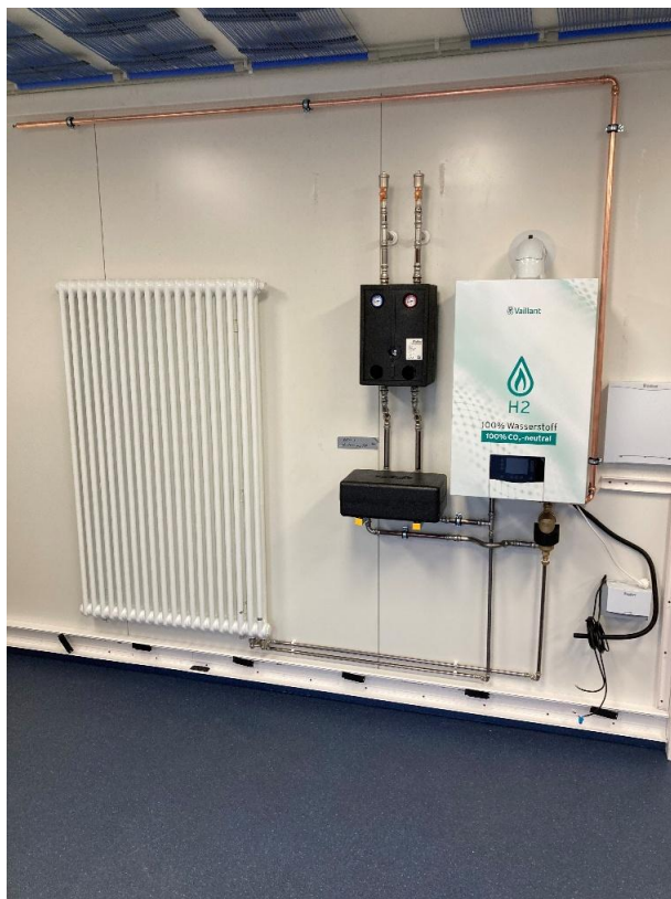
Abbildung 16: Installierte Wasserstofftherme von Vaillant
