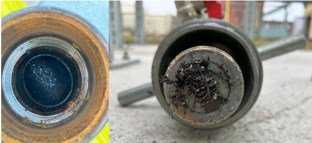
Abbildung 40: Metallspäne in der Rohrleitung und entfernte Späne
