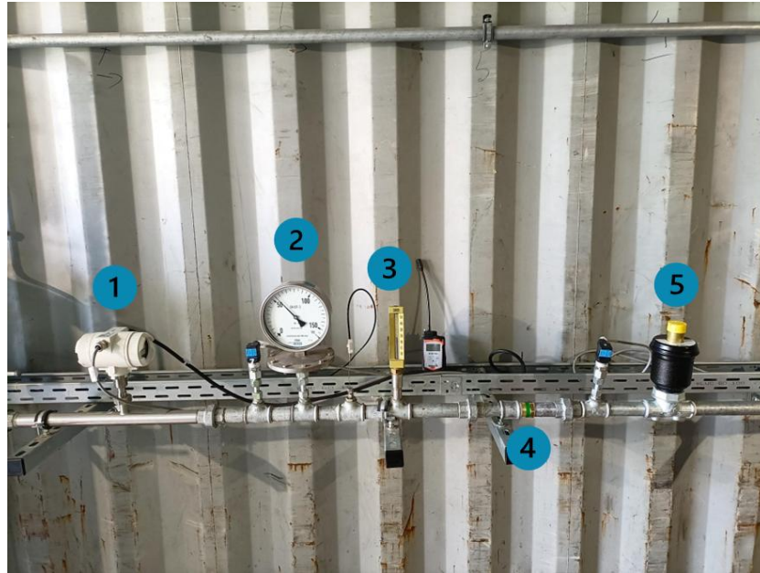
(1) Durchflussmessgerät (2) Eingangsdruckmessung (3) Temperaturmessung (4) Gasströmungswächter (5) Druckregelgerät
