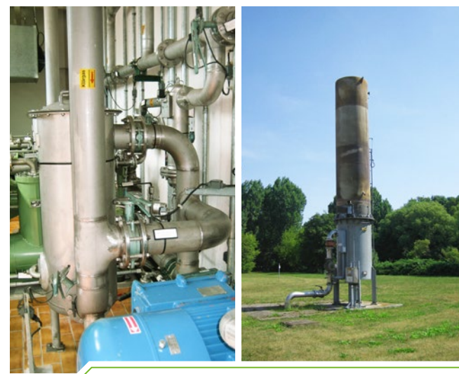
Gazonośne elementy instalacji
