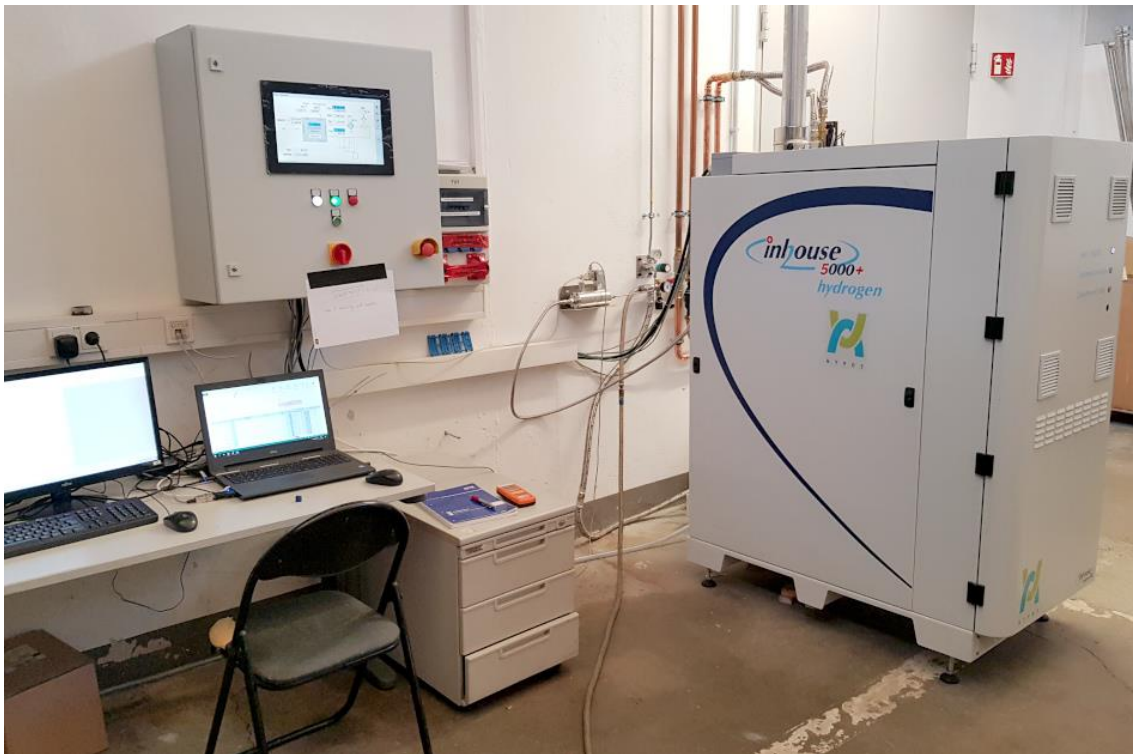
Abbildung 1: wasserstoffbetriebenes Brennstoffzellen-BHKW mit Spitzenlastkessel am DBI Versuchsstand
